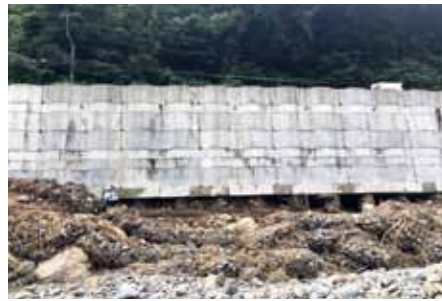
写真 6 プレキャストパネルによる山留式擁壁の基礎洗掘（2020年7月撮影）
