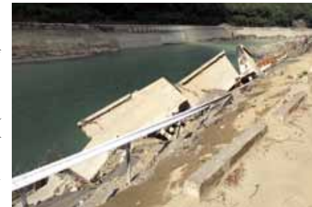
写真3 重力式擁壁の倒壊（2020年7月撮影）
