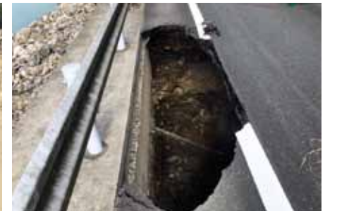
写真4 現場打横 矢板壁の路面陥没（2020年7月）
