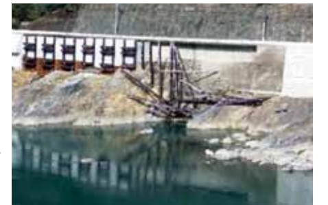
写真5 施工中の現場打横矢板壁の親杭座屈（2020年7月撮影）
