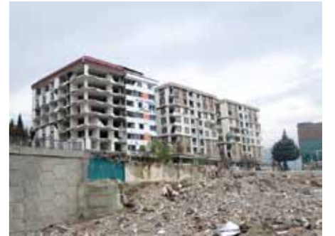
写真1 中層集合住宅の被害
