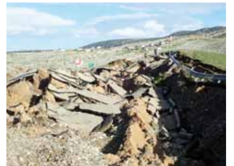
写真3 道路盛土の被害
