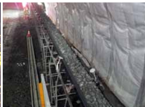
写真2 ベルトコンベヤ設備
