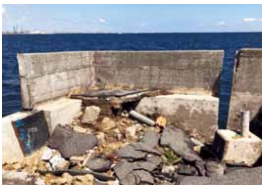
写真-3 長浜水路南側被災状況
