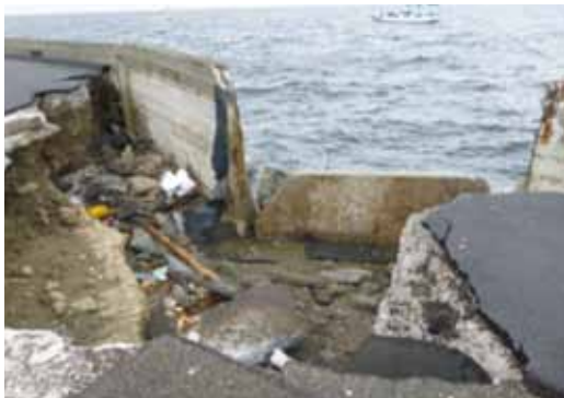
写真-1 L型擁壁倒壊・陥没状況
