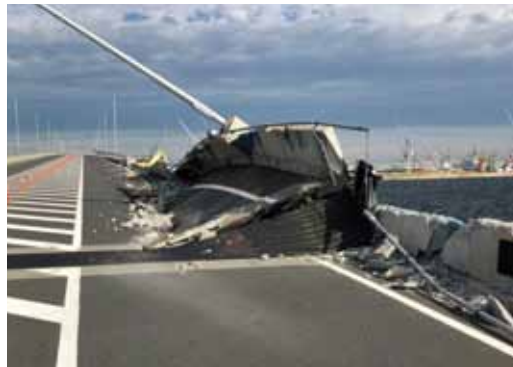
写真-7 はま道路被災状況
