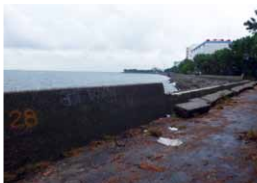
写真-4 護岸上部工倒壊状況
