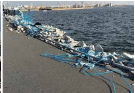
写真-8 はま道路被災状況
