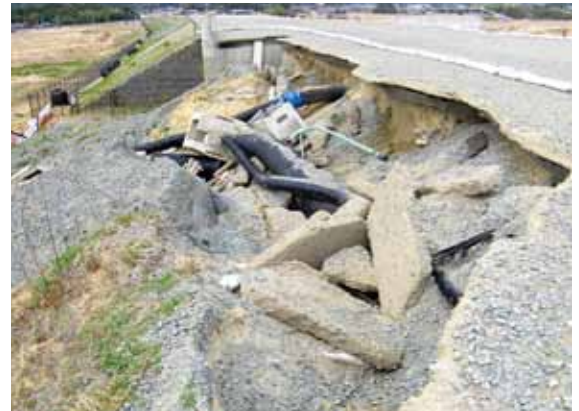
写真 1 アクセス道路の被災状況
