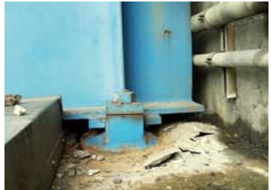
写真-1 地震の影響を受けた橋の支保部の損傷例
