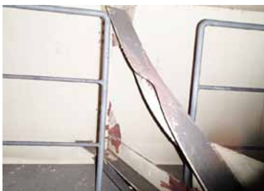
写真-9 地震によってゆがんでしまった対傾構
