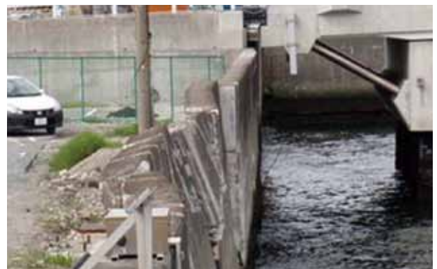
写真6 上部工破損状況 (護岸際から撮影)
