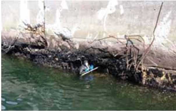
写真3 ケーソン天端付近の破損状況
