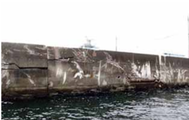
写真5 上部工破損状況 (海側から撮影)
