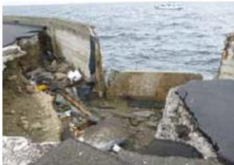
写真-1 L型擁壁倒壊・陥没状況
