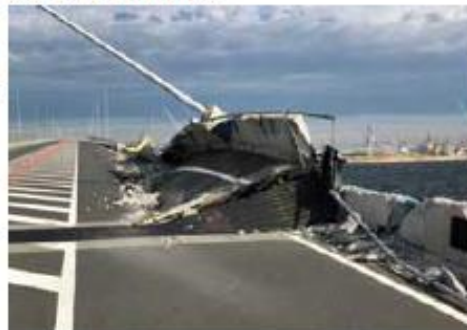
写真-7 はま道路被災状況
