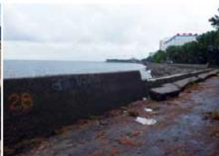
写真-4 護岸上部工倒壊状況
