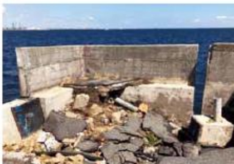
写真-3 長浜水路南側被災状況
