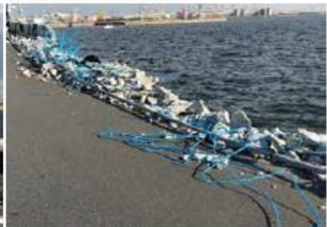
写真-8 はま道路被災状況
