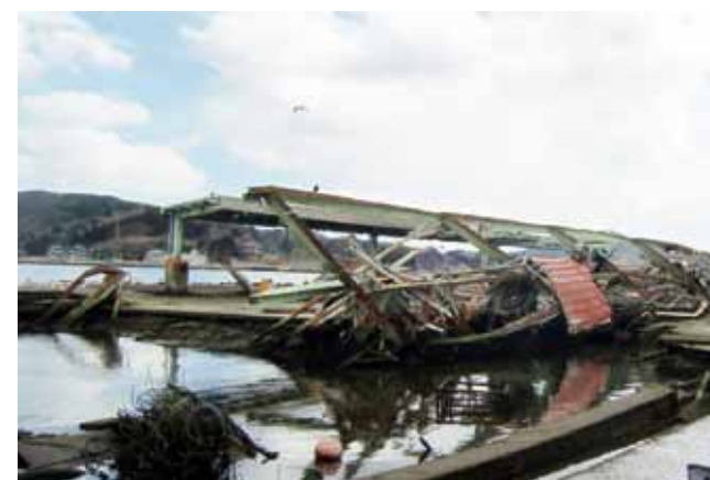
気仙沼漁港の建物崩壊
