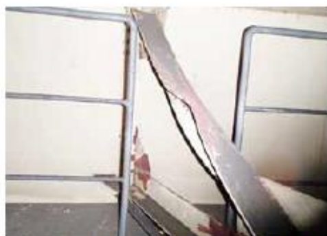
写真-9 地震によってゆがんでしまった対傾橋
