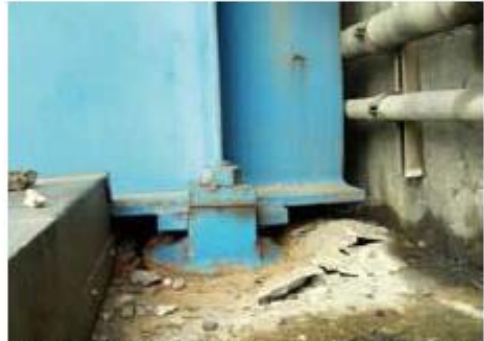
写真-1 地震の影響を受けた橋の支点部の損傷例
