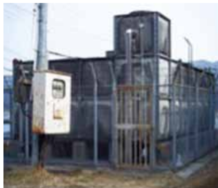
受水槽の漏水等劣化が進行
