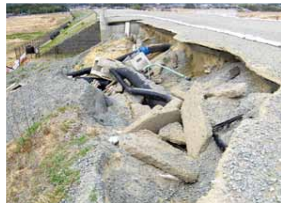
写真 1 アクセス道路の被災状況
