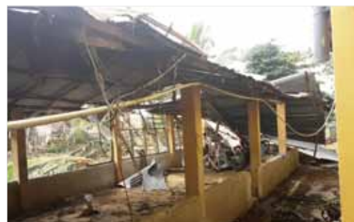
写真9 破損した一階部分
