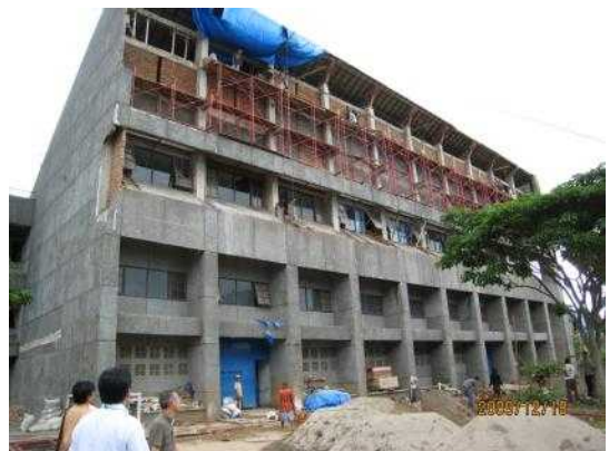
写真 4 アンダラス大学のレンガ外壁の被害
