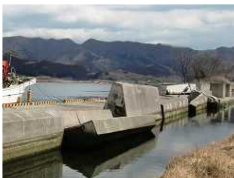
写真 3 沿岸部被害、地盤沈下と破壊(大船渡)
