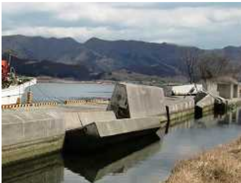
写真 3 沿岸部被害、地盤沈下と破壊(大船渡)
