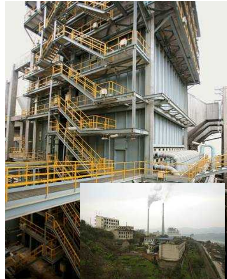
環境モデル都市(重慶市)：火力発電所排煙脱硫装置
