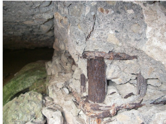
(d) Corroded steel bars of a pile (NW-Ab.)
