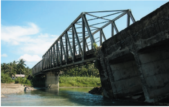
写真-1 サウォ川橋梁の被害：橋台・橋脚の傾斜
