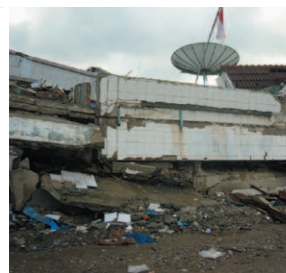
写真-4 RC建築物のパンケーキ崩壊
