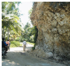
写真-2 岩盤斜面の崩壊：オーバーハンクしている
