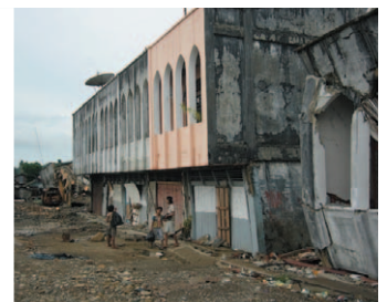
写真-5 液状化による建物に沈下、傾斜。道路に噴砂が見える
