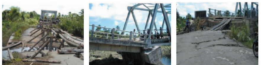
図-3 ムゾイ川橋梁の被害：液状化に伴う地盤流動(インドネシア公共事業省・提供)
